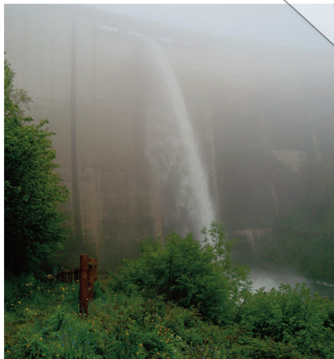
Léger déversement du barrage des Cammazes à partir du 1 er juin 2013.
