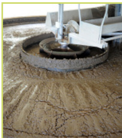
Flottateur de l'usine d'effluents.
