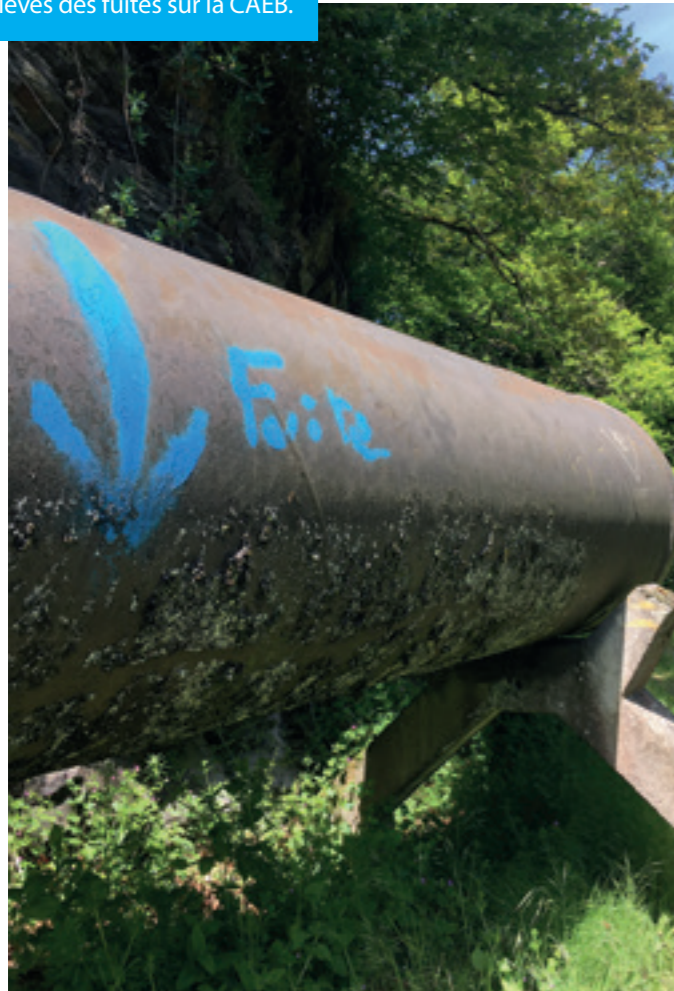
Relevés des fuites sur la CAEB.
