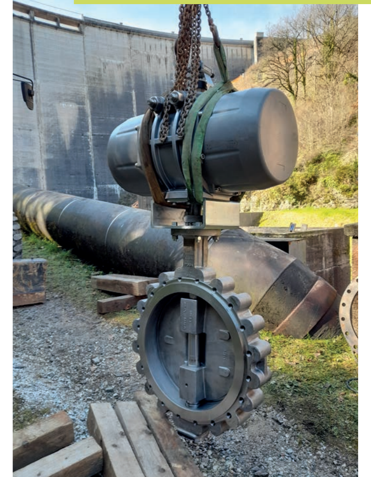
Nouvelle vanne d'isolement du circuit by-pass.
